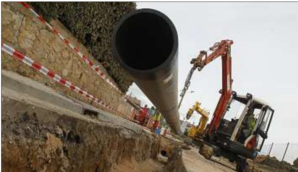
La canalisation reliera la station de pompage de l'eau du Roubaud, sur le parking du gymnase des Rougières, et le bassin d'infiltration au dessus de la nappe phréatique du Gapeau, près du lycée agricole.
